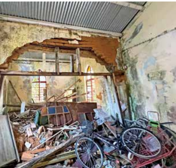
天主堂內部有牆身倒塌。(讀者提供)
