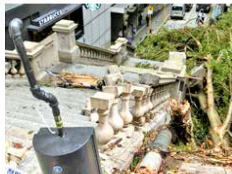
「山竹」襲港，石階及煤氣燈受到嚴重破壞。
