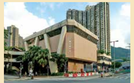
顯徑體育館近天花窗戶不能開啓，僅靠出入口通風。
