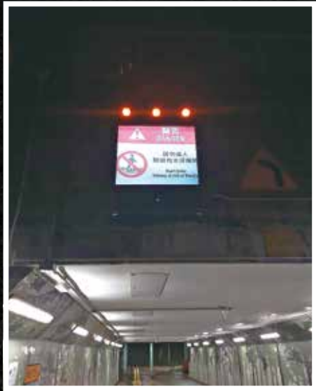
大埔的行人隧道水浸警告系統去年啟用。
