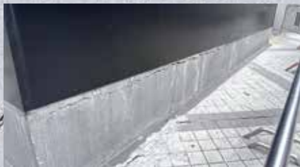
今年4月石籬商場外牆發現長長裂痕。
