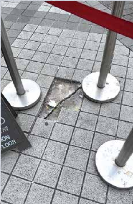
地磚下路面出現一條長30厘米裂痕。
