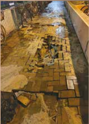
銀灣邨廣場對出行人路5月中有水管爆裂。
