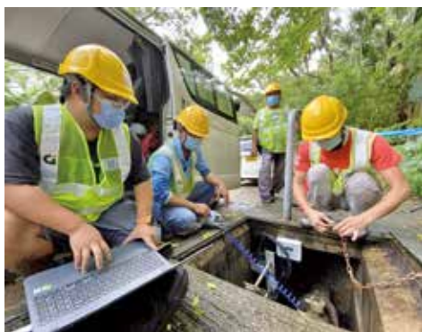
水務署以「智管網」數據，監察供水管有否滲漏。
