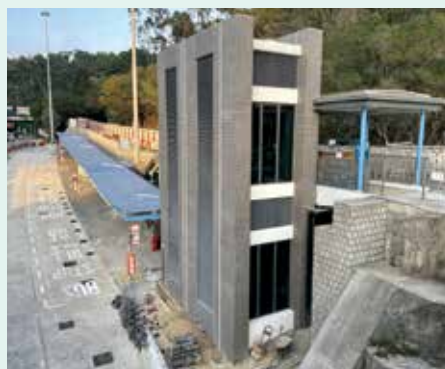
站內兩部升降機進行最後階段測試。
