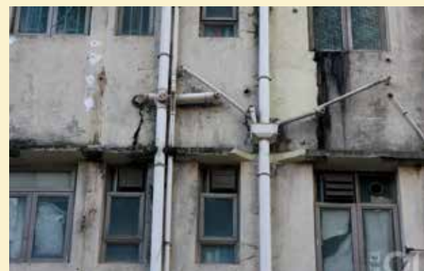
不少逾 50 年樓齡樓老化失修。
