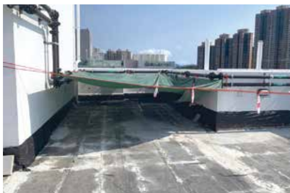
雍明苑入伙後，被指天台防水工程不足。
