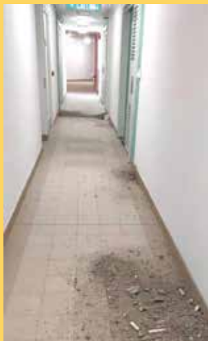
居民投訴指樓層梯間有人亂棄廢料，無人清理。
