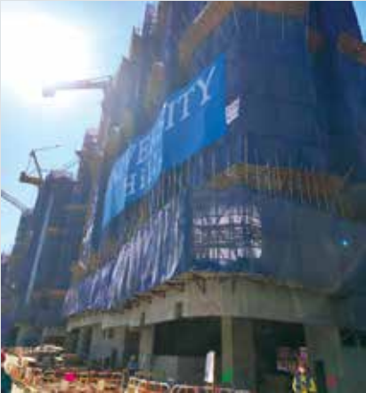
意外發生於白石角優景里住宅地盤。
