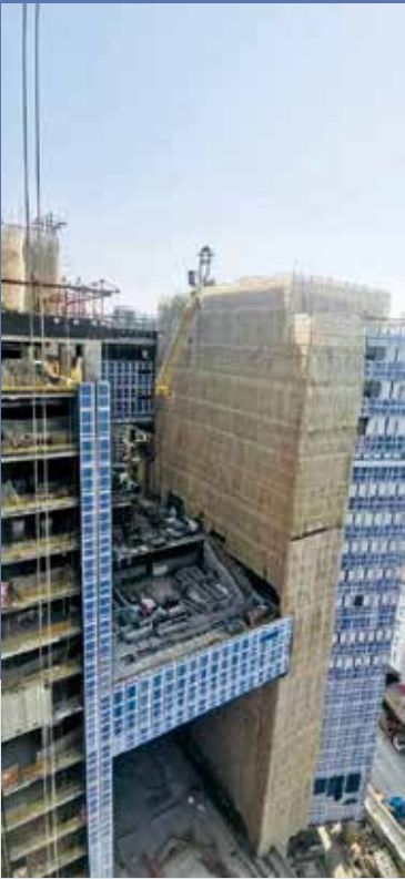
入境處總部地盤，上月有天秤折斷倒塌。
