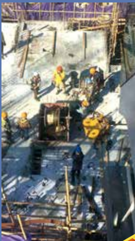
白石角地盤，男工掛地，被天秤吊鉤擊中倒地。
